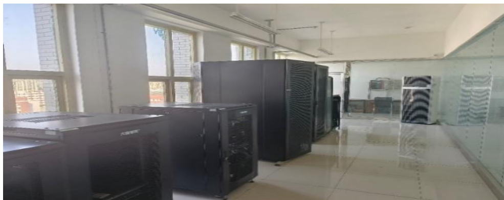
图 15 数据中心机房
